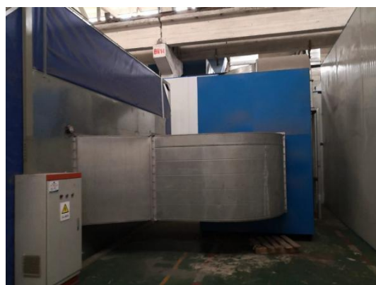
喷漆废气处理装置
